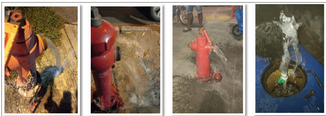
Ilustración 3 Purgas en hidrantes
