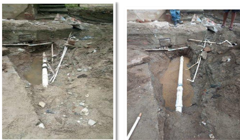
Ilustración 34 Desconexión de acometidas ilegales en redes de distribución
